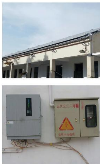
谷亭街道东段村光伏发电
