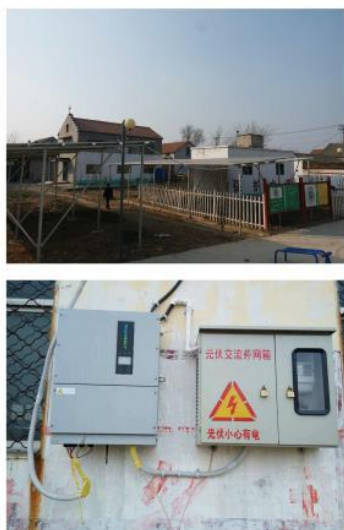
谷亭街道八里湾村光伏发电
